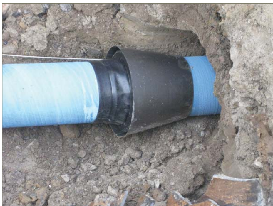
Hrdla trub při zatahování jsou chráněna pryžovými manžetami a ochrannými límcí, stavba Litovel
